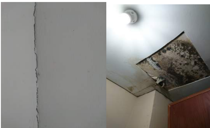
Gambar 11 Tembok Retak dan Langit-Langit Bocor di Rumah Susun Baru Jatinegara Barat (Foto: LBH Jakarta)
